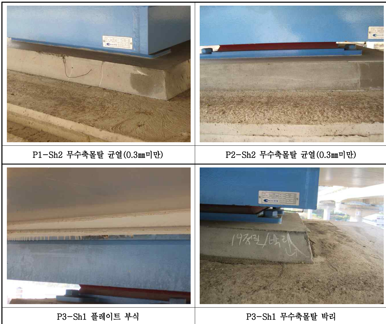
【사진 42.3.11】 교량받침 손상현황
