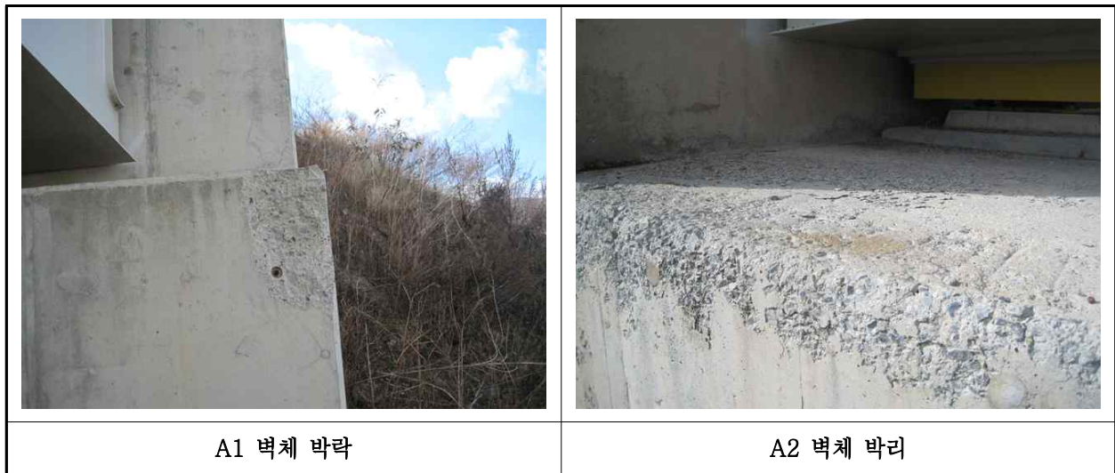
【사진 42.3.7】 교대 손상현황
